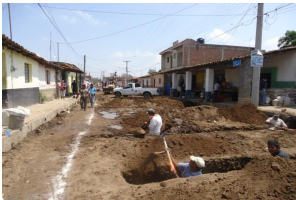
GUARNICIONES Y BANQUETAS CALLE JUAREZ, USMAJAC.
